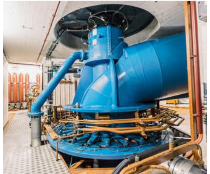
In einem 58 Meter tiefen Schacht sind die maschinellen Anlagen untergebracht.
